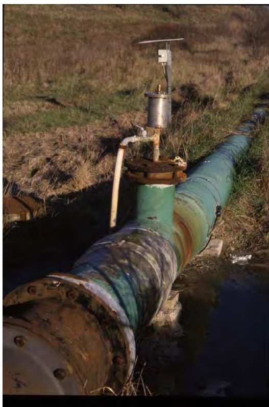
Particolare di un tratto della tubazione che trasporta la soluzione salina allo stabilimento di Rosignano Solvay
