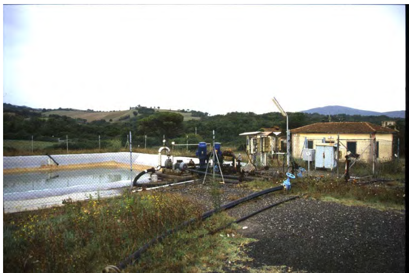
Impianti di pompaggio e vasca di decantazione
