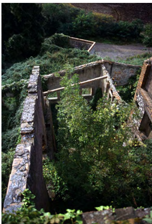
In primo piano la laveria e sullo sfondo il deposito di stoccaggio del minerale (020a)
