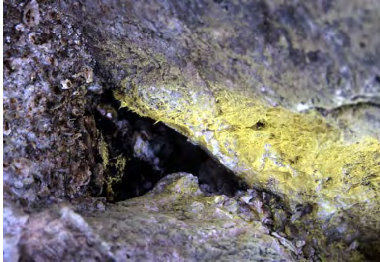
Efflorescenze di cristalli di zolfo
