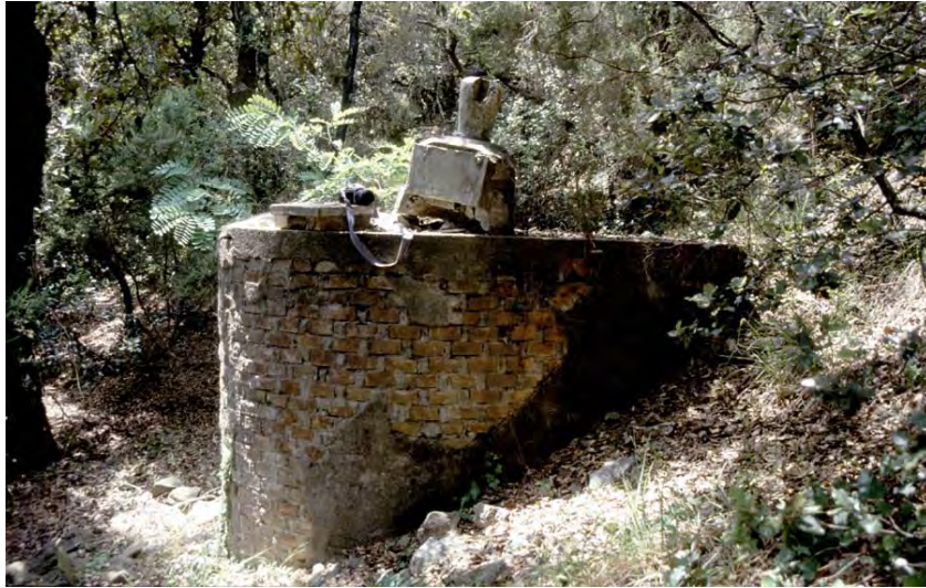
Pozzo di ventilazione (003e)
